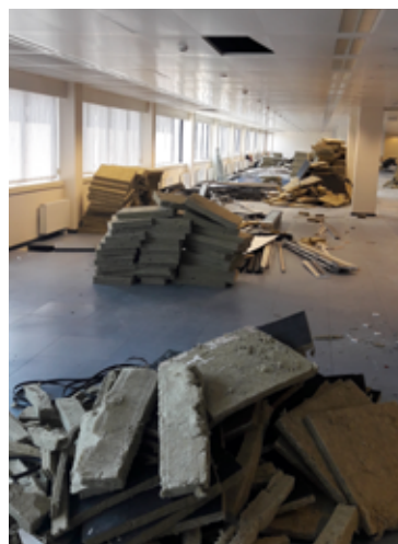
Sorteren van isolatie in minerale wol van interne scheidingswanden, herinrichtingsproject van de RSZ-gebouwen in Brussel (BE)
