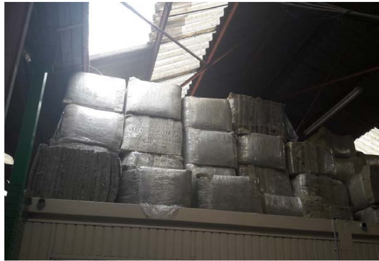
Stockage d'isolants en laine minérale provenant de cloisons intérieures, avant leur remise en œuvre comme isolation de toiture inclinée
