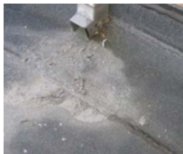
Exemple de dépôt, au pied d'une descente d'eaux pluviales, de matériaux contenant de l'amiante et provenant d'une couverture contenant de l'amiante (photo OVAM, 2018)
