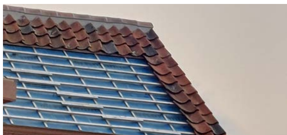
Exemple de fixation traditionnelle (au mortier) de tuiles faîtières dans le cadre d'une rénovation de toiture récente (2023) tout en conservant l'aspect authentique (photo F. Dobbels).
