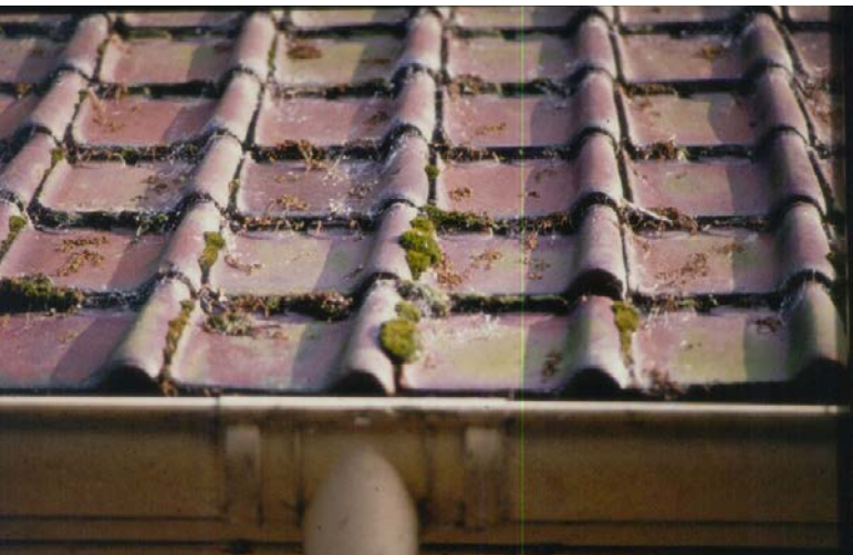
Exemple de formation de mousse sur les tuiles © Buildwise
