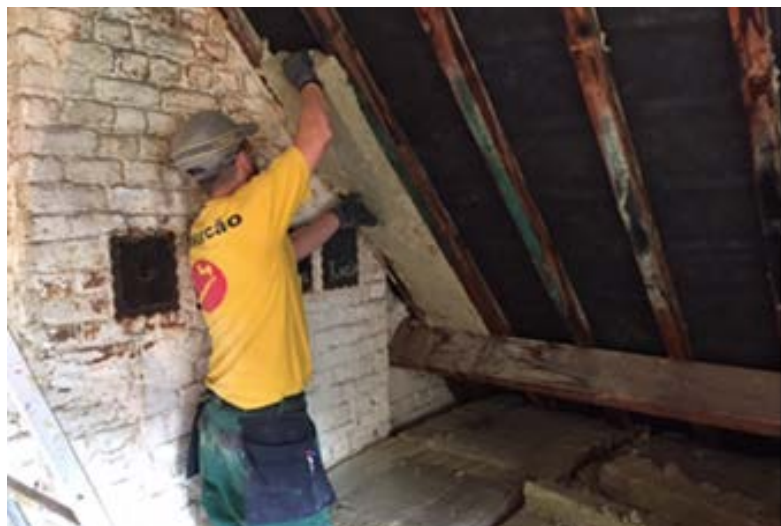
Remise en œuvre d'isolants en laine minérale provenant de cloisons intérieures d'un bâtiment de bureaux à Bruxelles (ONSS)
