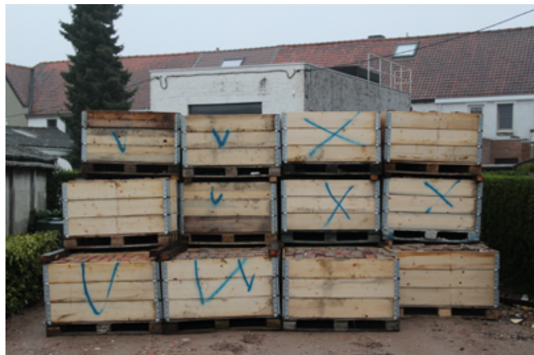
Briques triées sur chantier en différents bacs selon leur conformité aux critères requis – Chantier Tuighuisstraat
