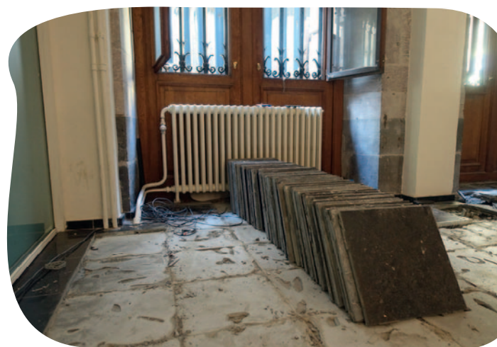
Ontmanteling van een natuurstenen tegelvloer, Antwerpen 2018. Deze tegelvloer is geïdentificeerd in een inventarisatie van het potentieel voor hergebruik van de aanwezige elementen in een openbaar gebouw. De tegels worden gedemonteerd door een gespecialiseerd bedrijf, die bovendien ook de verkoop ervan zal verzekeren. De waaier aan aanwijzingen classificeert het materiaal duidelijk als een product.
