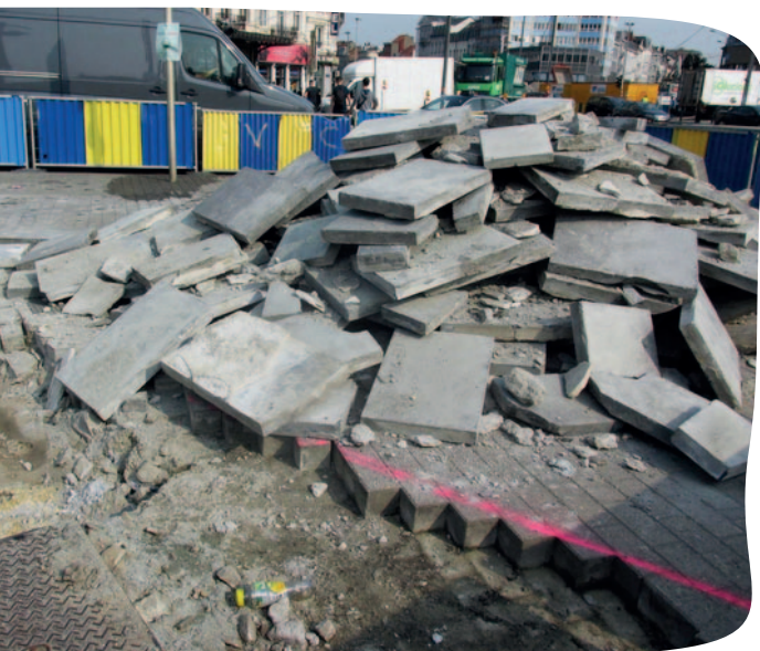
Bouwplaats op de openbare weg in Brussel, september 2020. De blauwe hardstenen vloertegels worden zonder bijzondere zorg ontmanteld: door deze handeling ontdoet de aannemer zich van de materialen en zet hij ze wettelijk om in afval.
