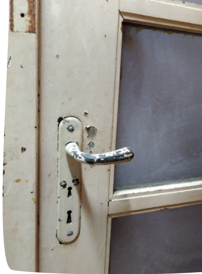
Afgebladderde verf op deur en deurknop
