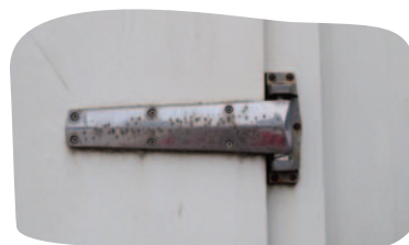
Het chroom van het scharnier van deze buitendeur is in de loop der jaren door de elementen aangetast.
