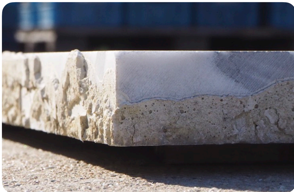
Présence de résidus de mortier
